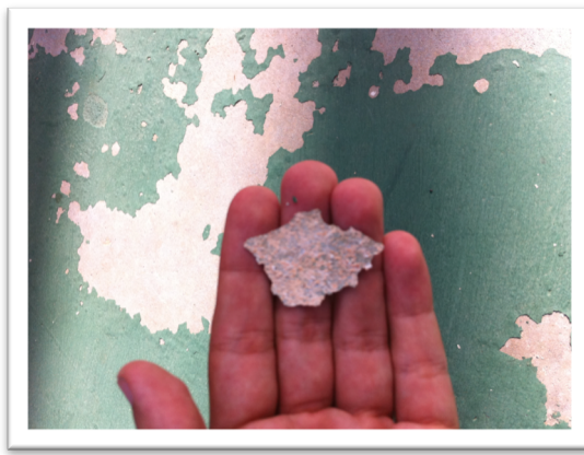
Figura 02: descolamento por falha do substrato.
